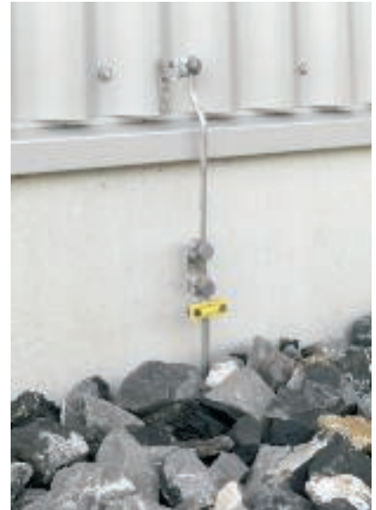
Место разъединения системы заземления
